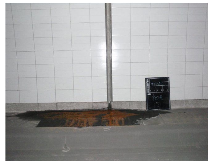
施工前漏水状況
