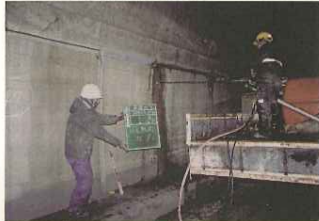
日中トンネルで、コンクリートの打ち継ぎ目の約30cm下に、ベースホールと呼ぶ直径12cmの穴を掘削しているところ (37ページまでの写真：特記以外は寿建設)
